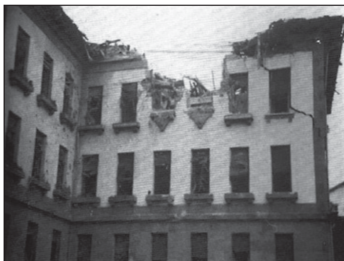
Fig. 24. Destrozos en la Casa de la Maternidad.
